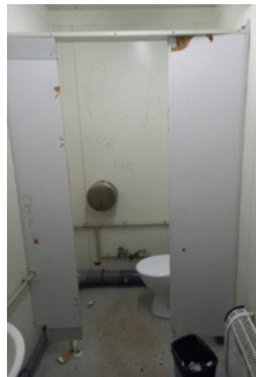
Zniszczona publiczna toaleta.
