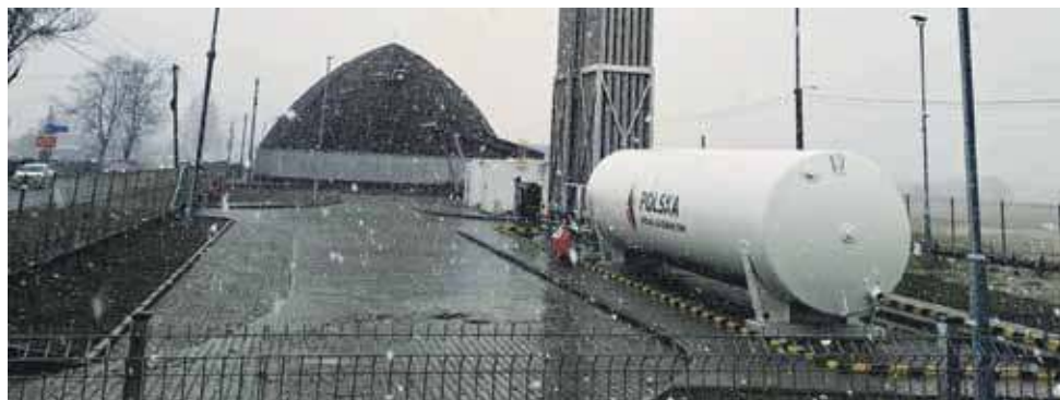
Stacja przesyłowa w Czarnym Dunajcu.
