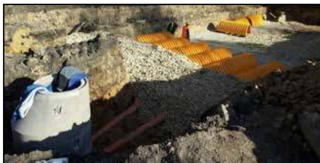
Oczyszczalnia ścieków w technologii SBR
