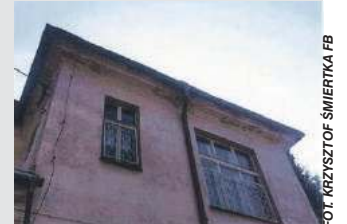
Stan budynku pozostawia wiele do życzenia
