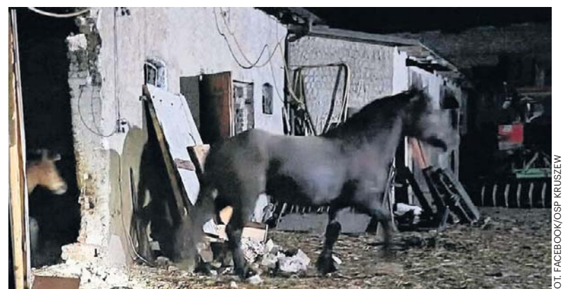
Strażacy wyprowadzili konie w Woli Pniewskiej ze stajni, w której runął strop.
