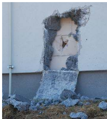
Sprawcy uszkodzili elewację.
