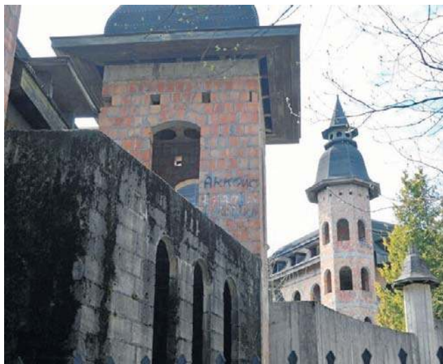
Obiekt jest niebezpieczny ze względu na pogarszający się z roku na rok stan techniczny
