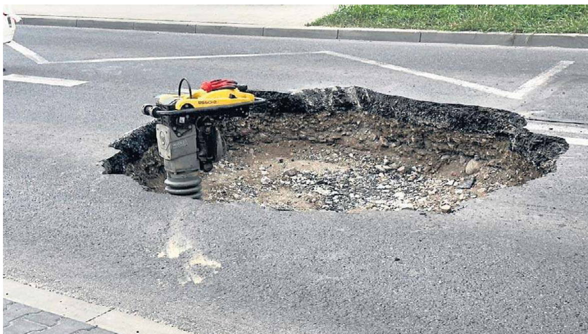
Dziura w jezdni na Kwiatkowskiego została częściowo zasypana, trzeba jeszcze wylać beton i asfalt.
