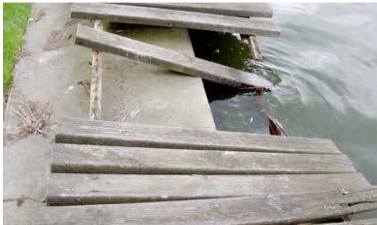
Drewniana kładka w takim stanie zagraża bezpieczeństwu użytkowników
