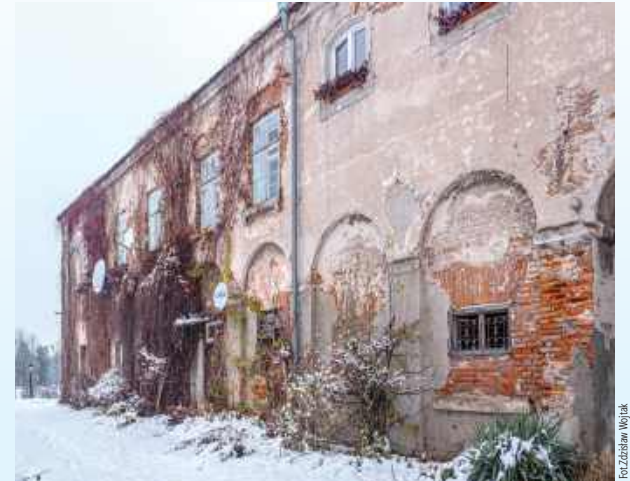
Plany remontów są od lat. Historyczny budynek w Zamościu tymczasem niszczeje i wygląda coraz gorzej
