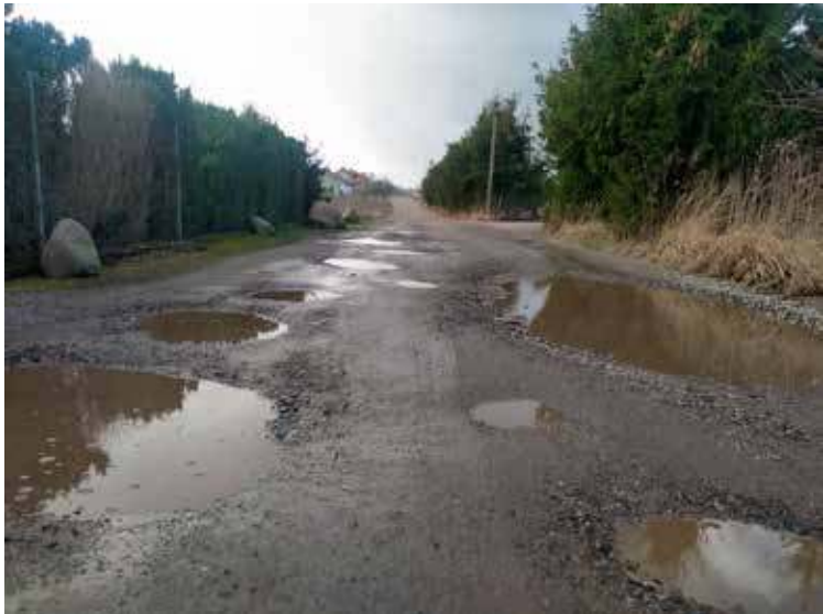
Stan drogi usłanej na całej szerokości dziurami woła o pilne naprawy
