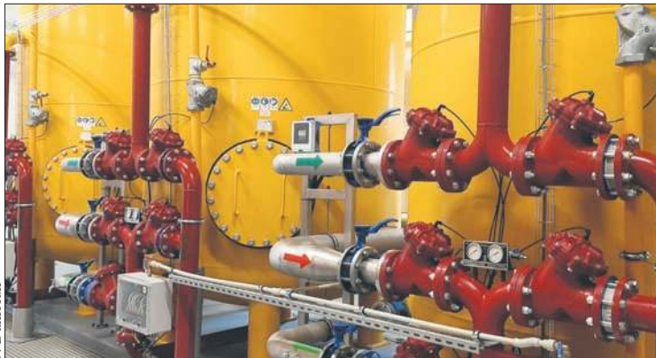
Urządzenia wykorzystywane w procesie uzdatniania wody w stacji w Górach
