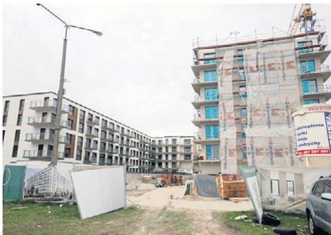
Budowa drugiego etapu inwestycji Belg Apartamenty. Osiedle powstaje w miejscu kultowego „Belga”
