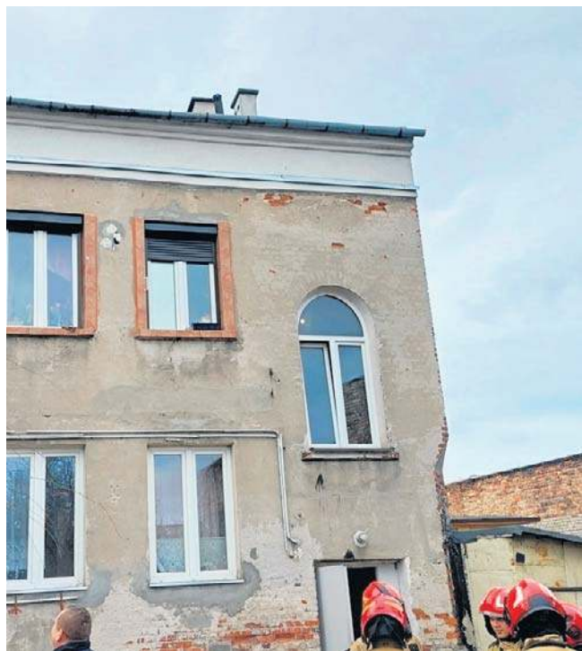
W kamienicy przy ul. Łęskiej 44 popękła ściana nośna. Inspekcja stwierdziła, że nie ma zagrożenia zawalenia
