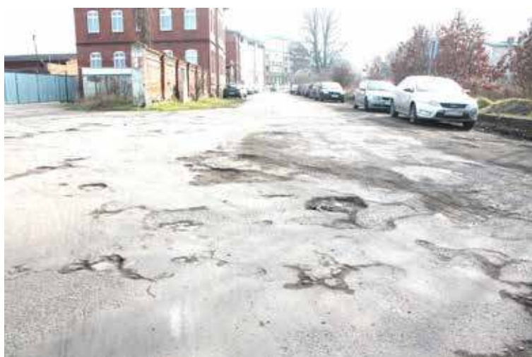
Dziury na ulicy Rzeźniczej
