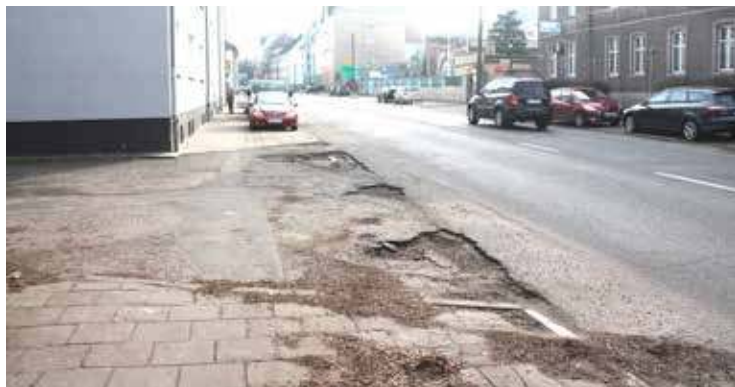
Stan odcinka drogi na ulicy Okrzei
