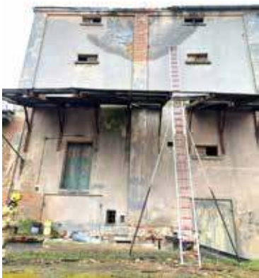
17 lutego strażacy zostali zadysponowani do uszkodzonego dachu na budynku przy ulicy Kolejowej. Foto. OSP. Dolice
