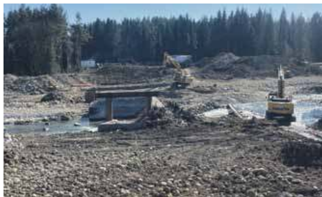
Aż trudno uwierzyć, że w tym miejscu był kiedyś most.
