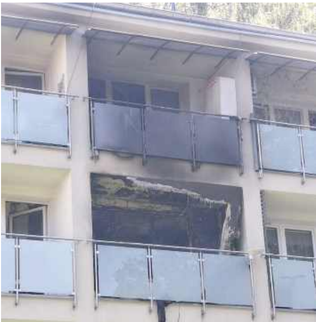
Spalone mieszkania przy ul. Fabrycznej w Poniatowej. Prokuratura nadal ustala, co doprowadziło do tragicznego pożaru
