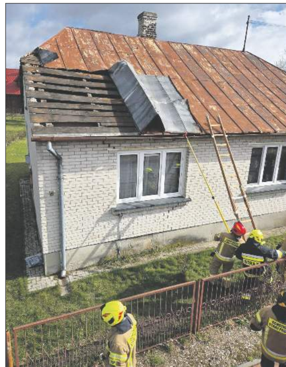
❖ Strażacy z PSP w Rykach oraz druhowie ze Stężycy w Lany Poniedziałek zostali zadysponowani do zerwanego dachu na jednym z domów w Stężycy (fot. OSP Stężyca)
