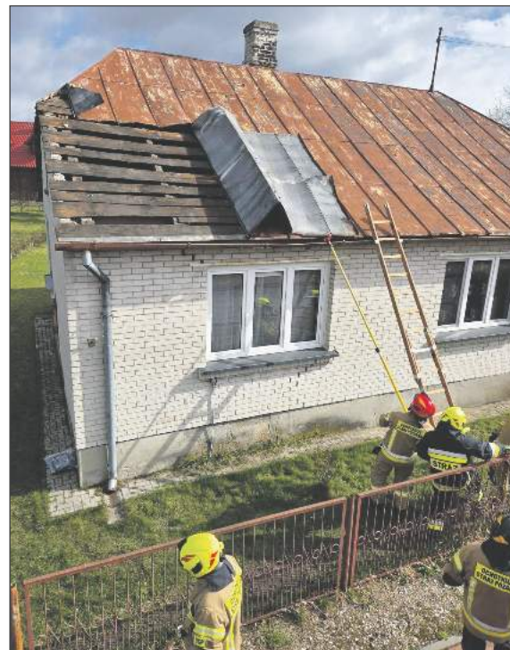
❖ Strażacy z PSP w Rykach oraz druhowie ze Stężycy w Lany Poniedziałek zostali zadysponowani do zerwanego dachu na jednym z domów w Stężyca (fot. OSP Stężyca)
