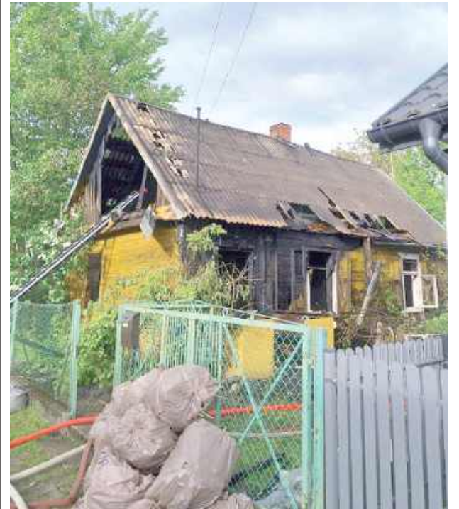
Po pożarze budynek nie nadaje się do zamieszkania
