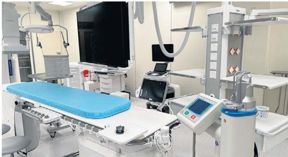
W nowej pracowni wykonywane będą zabiegi wszczepiania nowoczesnych urządzeń monitorujących i wspomagających pracę serca
