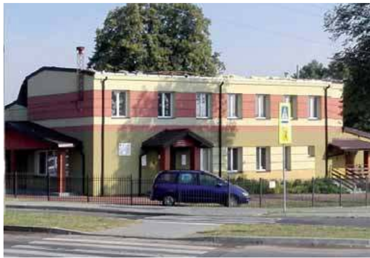
Uszkodzony dach świetlicy ma zostać naprawiony
