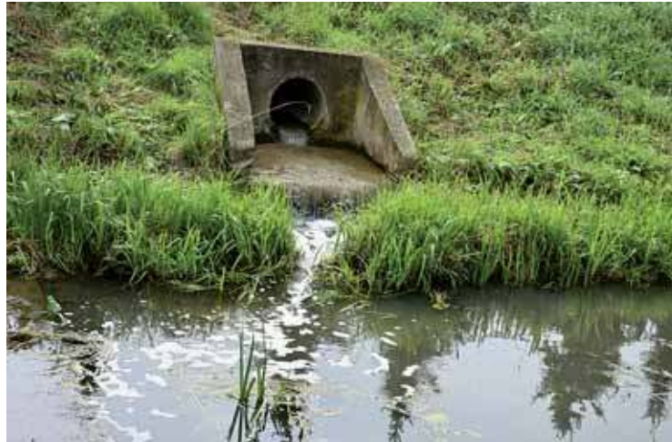
Z tego kolektora do rzeki mogła dostać się szkodliwa ciecz
