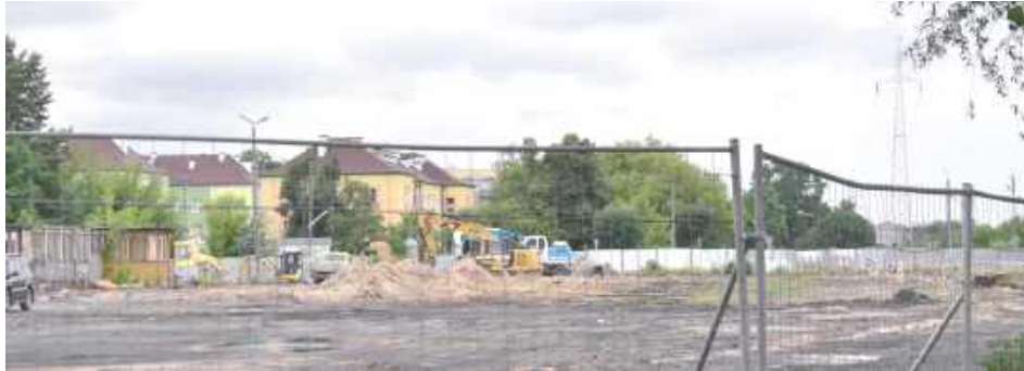
Na działce przy ul. 15 Pułku Piechoty, gdzie przez lata funkcjonowało miejskie targowisko, dziś pracują koparki i ciężki sprzęt
