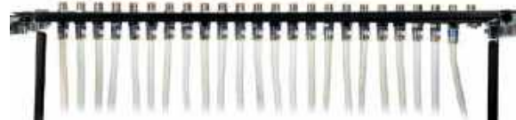
Wszystkie sygnały wyjściowe do abonentów dostępne są na patch panelu szafy 19"
