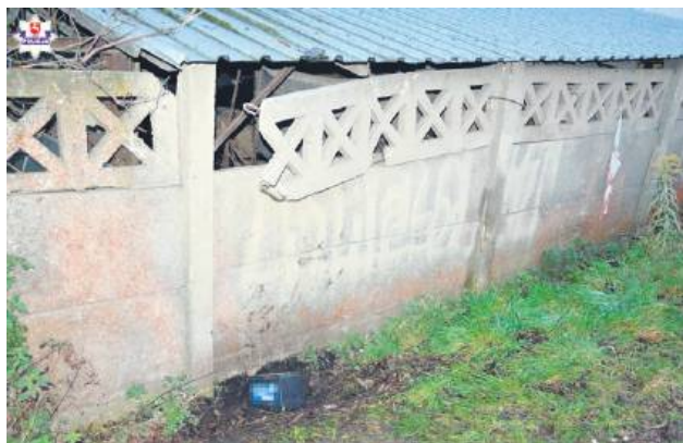
Podejrzani uszkodzili betonową ścianę wiaty i przedostali się do wnętrza. Fot. KMP Zamość
