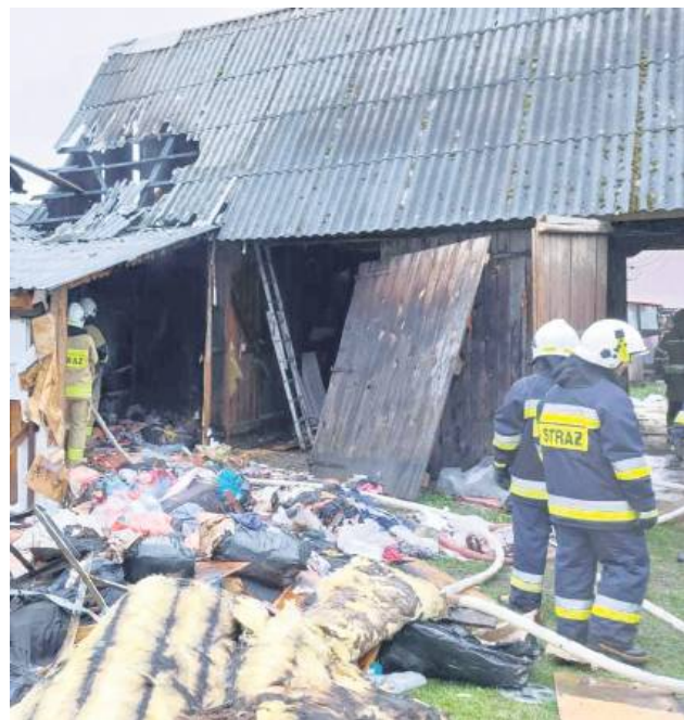
Spalił się drewniany strop w budynku gospodarczym i jego wyposażenie, a także fragment dachu na stodołę. Fot. Tomasz Stempel
