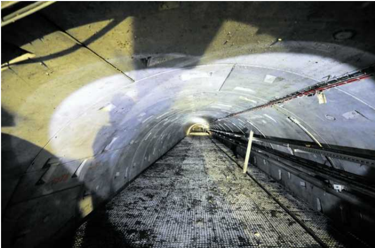
• Wrzesień 2020 r. Kanał przesyłowy ścieków do oczyszczalni Czajka po awarii FOT. JACEK MARCZEWSKI / AGENCJA WYBORCZA.PL
