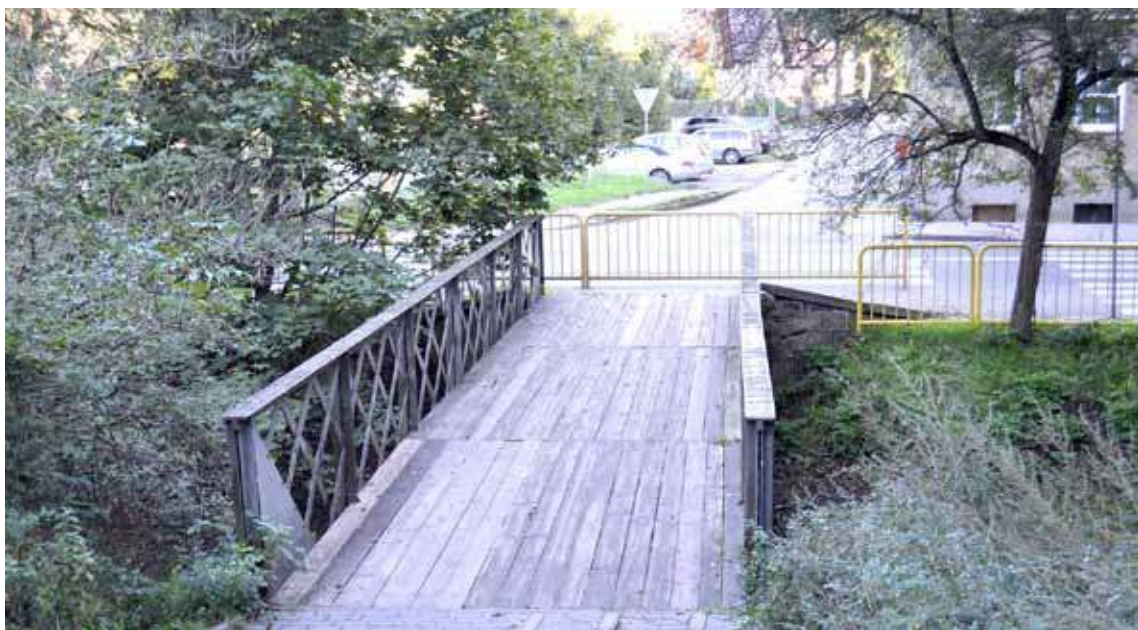
Od dzisiaj mostek przy ulicy Marii Skłodowskiej-Curie i Ochronnej został zamknięty
