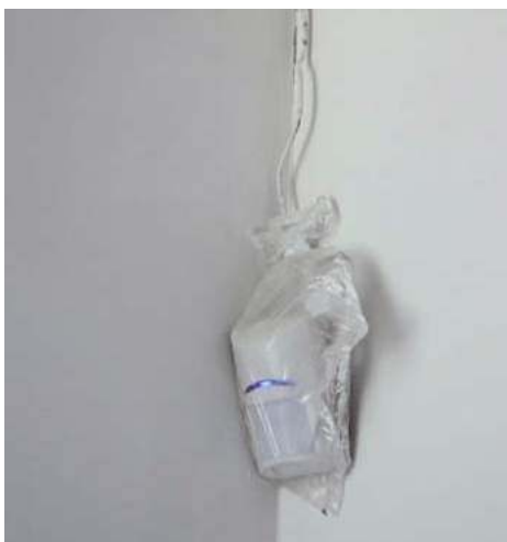
🔗 W instalacji alarmowej montowanej na etapie budowy, czujki łączą z centralą przewody ukryte pod tynkiem. J. WERNER
