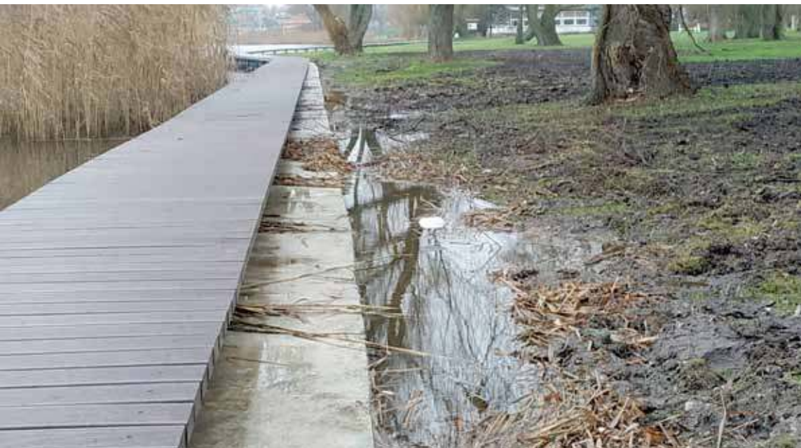
Tuż przy nowej budowlu, zaraz po większej ulewie, zalegają sporej wielkości kałuże wody
