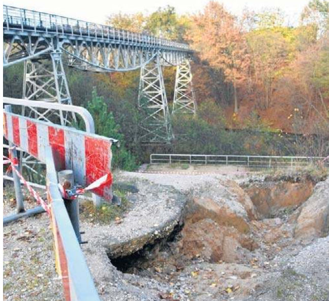
Jesienią osunęła się ziemia. Most kolejki wąskotorowej w Koronowie ocalał, ale zejście na taras widokowy przy moście zagraża turystom. Postawiono barierki
