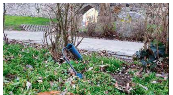
Kabel wystaje z ziemi już od dłuższego czasu.
