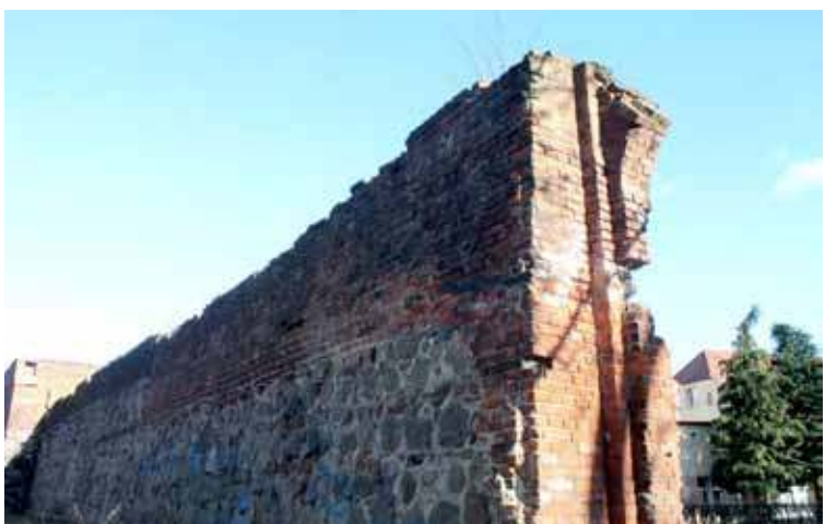
Widoczne u góry wyszczerbienia murów to też częsty widok
