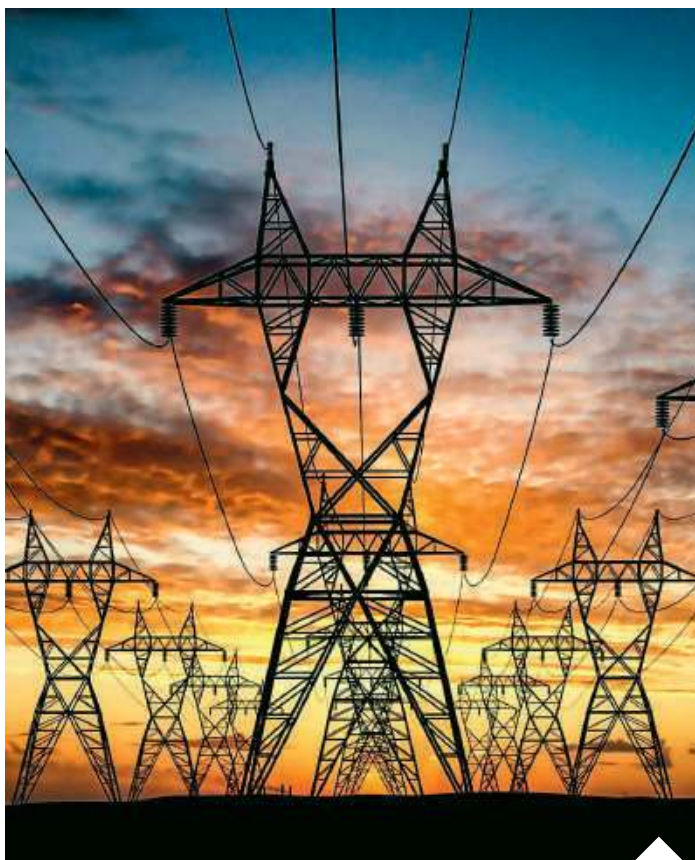
Podczas letnich upałów sieci elektroenergetyczne są bardzo obciążone
