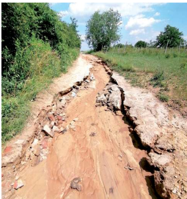
Zdjęcie wykonane przez Czytelnika. Tak wyglądała ulica Wesoła w Karczmiskach Pierwszych po przejściu czerwcowej nawałnicy. Spływająca woda wyżłobiła głębokie wyrwy w drodze
