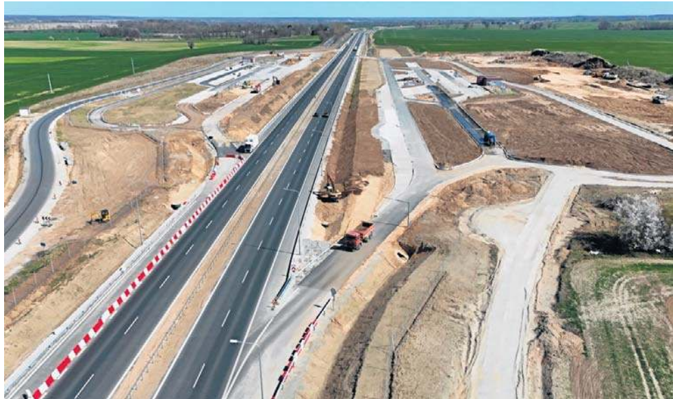
Przy trasie ekspresowej S6 w Karwicach w pobliżu Sławna trwa budowa MOP - czyli Miejsca Obsługi Podróżnych
