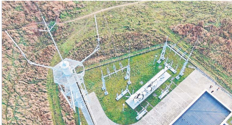
Instalacje nowoczesnego systemu łączności TETRA
