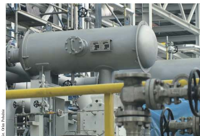
Tak wygląda nowa instalacja do produkcji glikolu w Trzebini
