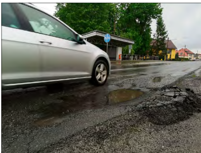
Fragment uszkodzonej jezdni w Steblowie ma być naprawiony. Takie zapewnienia daje Zarząd Dróg Wojewódzkich w Opolu.
