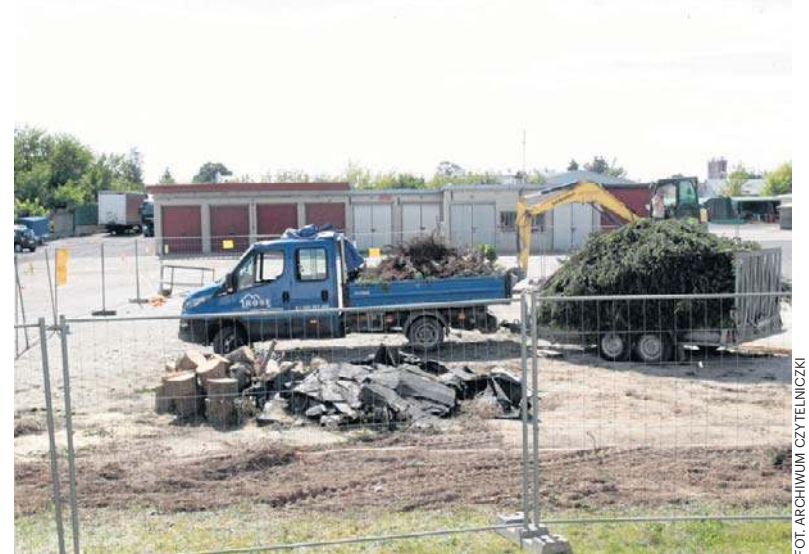
Tu stanie magazyn przeciwpowodziowy, przesłoni świat lokatorom bloku przy ul. Korczaka w Mielcu
