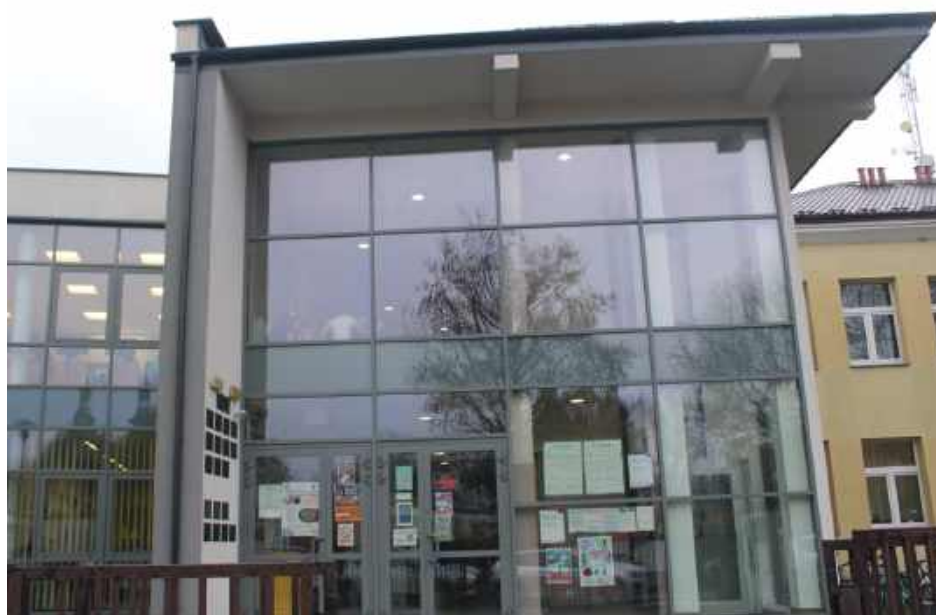
Dobudowa w 2018 r. nowa część szkoły z pozoru wydaje się nowoczesnym obiektem na miarę XXI wieku. Niestety od środka sprawa wygląda zupełnie inaczej
