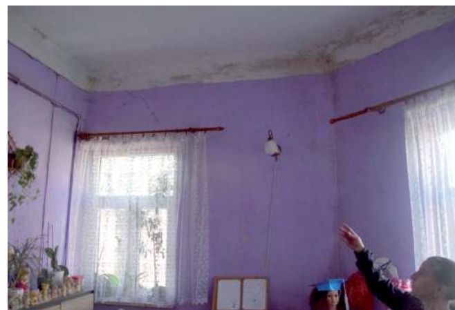
Stan niektórych mieszkań wymaga pilnego remontu
