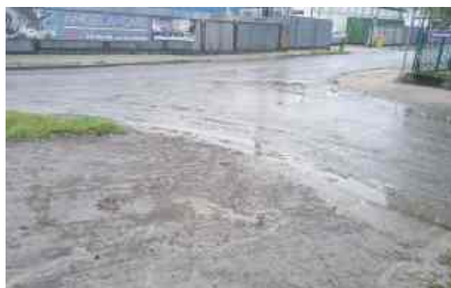
Skrzyżowanie Kwiatowej z Żeromskiego. Wody już nie ma, zostało błoto
