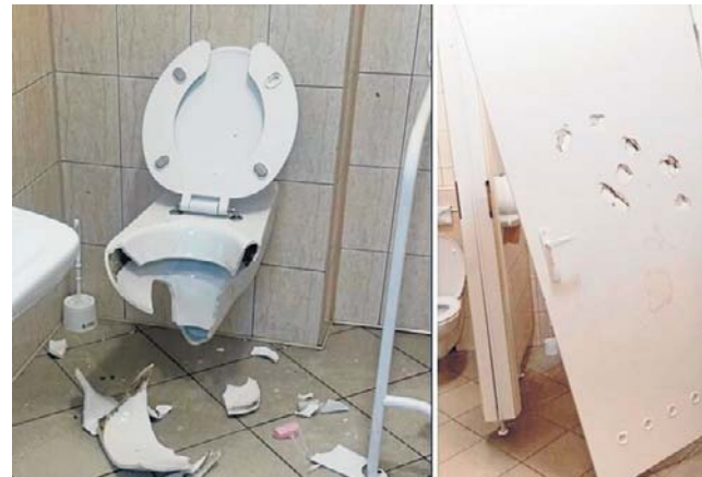
Powyrywane drzwi, pomazane ściany i uszkodzone wyposażenie – taki widok zastali użytkownicy szaletów miejskich przy placu Chopina
