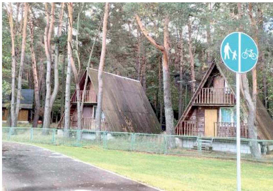
Drewniane domki nad zalewem Zimna Woda były wybudowane w latach 70. ubiegłego wieku. Ich stan jest zły. Wilgoć, pleśń zniszczyły drewno, dlatego nadają się tylko do rozbiórki
