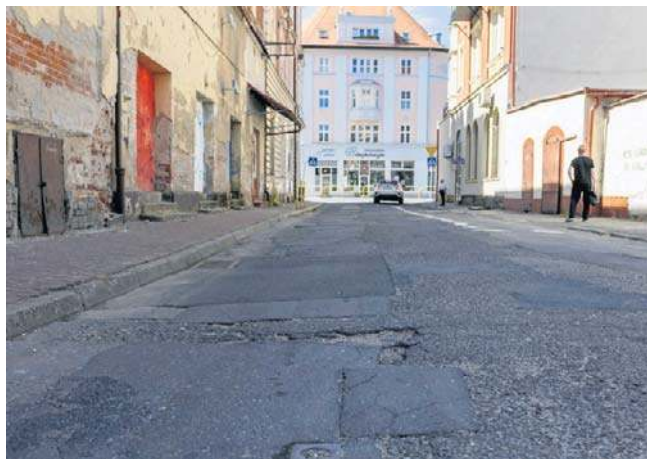
Nawierzchnia ulicy Murarskiej już od dawna domaga się remontu
