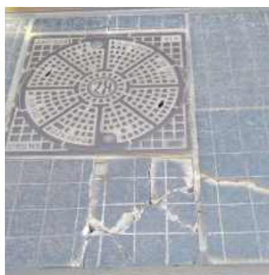
Takich uszkodzeń na Katowickiej jest sporo
