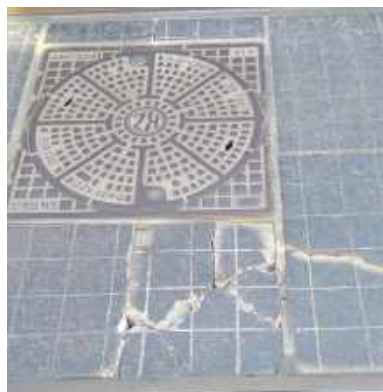
Takich uszkodzeń na Katowickiej jest sporo
