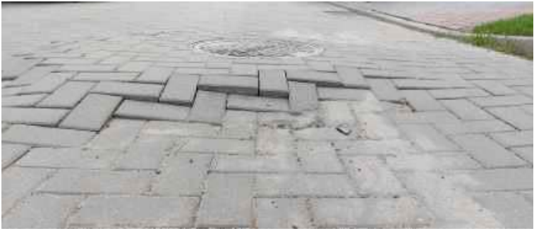
Zapadnięta kostka stanowi dla kierowców niebezpieczną przeszkodę
