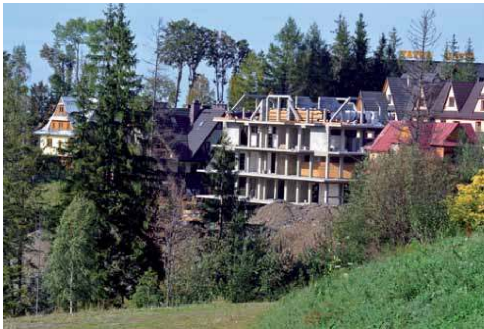
Nowy apartamentowiec na Cyrhli niemalże styka się ze ścianami sąsiednich budynków i zasłania im widok.
