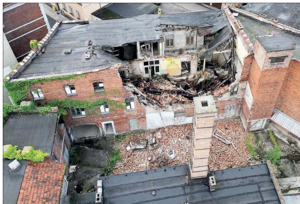
■ Remont budynku znajdującego się w ruinie ma zająć kilka lat, nie sprecyzowano na razie, ile dokładnie. Tymczasem zniszczenia postępują, doszło do częściowego zawalenia się.
