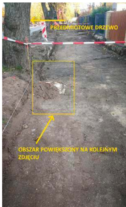
Podczas remontu ul. Dworcowej uszkodzone zostały korzenie drzewa
