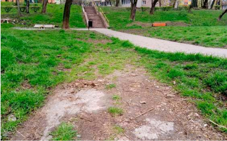
Tak wygląda stary chodnik przy ul. Maszynowej. Nasz Czytelnik uważa, że powinno się go oczyścić i wyremontować. ZNK składania się ku jego rozbiórce, ale póki co jest, jak jest
