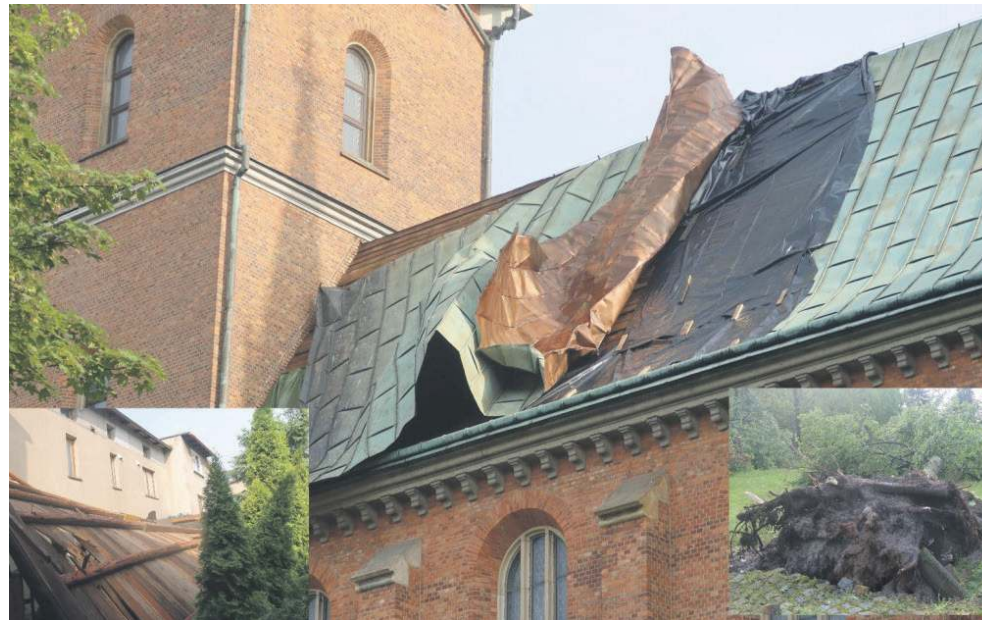
Uszkodzony dach trzebińskiej bazyliki
